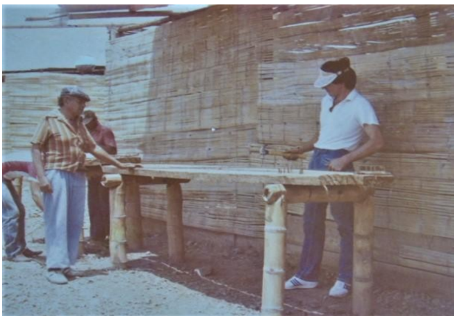
Figura 25: construcción de casa en esterilla y madera; barrio el Vallado; Año 1986 Fuente: Nelson Rodríguez, administrador Polideportivo Vallado.
