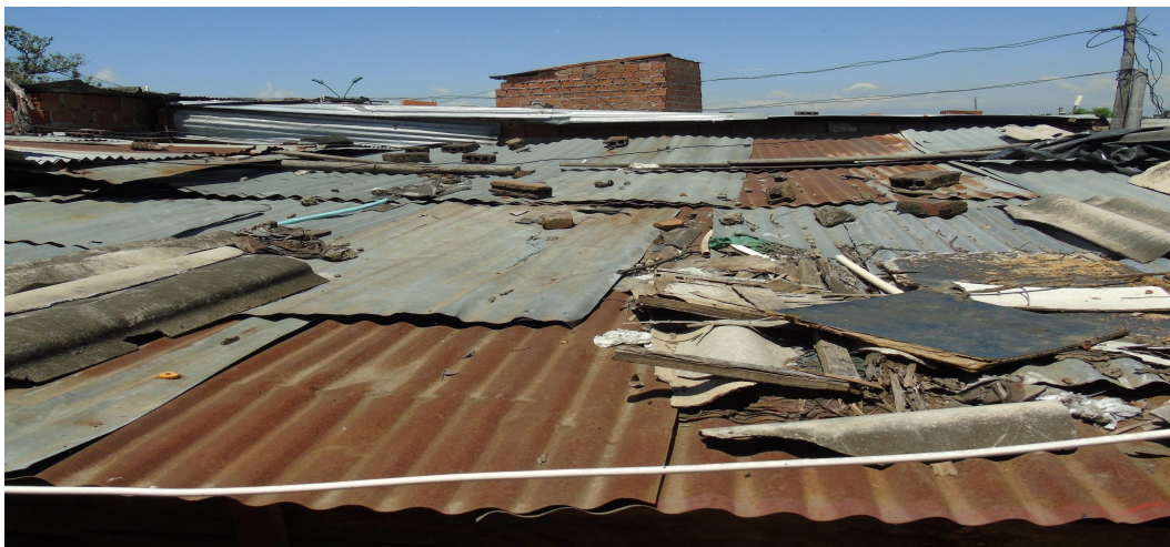
Figura 47. Techo vivienda de invasión Valladolid; tejas de zinc, Eternit, madera ladrillo; utilizadas también de ruta de escape; Año 2020; fotografía José Manuel Cuesta.
