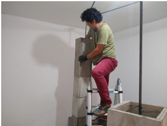
Imagen 35. Fotografía de los módulos empalmados a la estructura formando las columnas. Fuente de elaboración propia.
